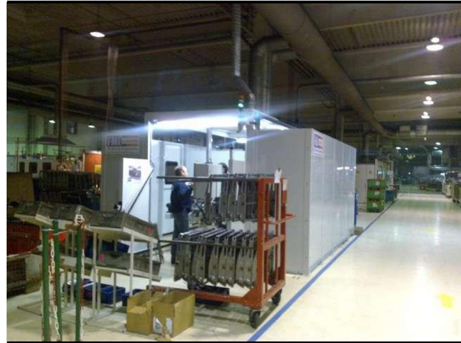
Cabina de soldadura MIG en funcionamiento
